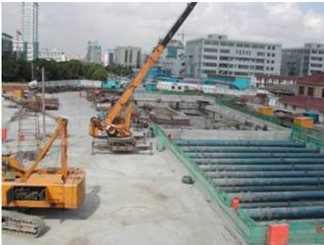
Hong Mei Rd. Station
